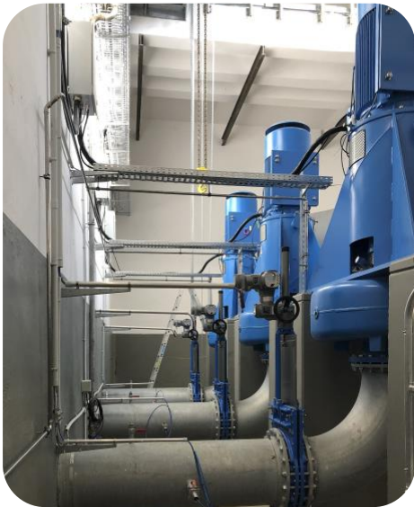
Vorflut-Pumpanlage Leyenburg Bild: LINEG
